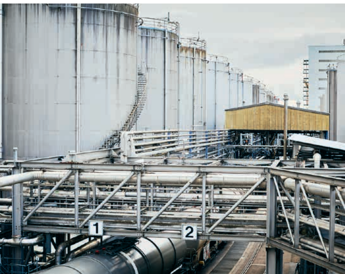
A Birsfelden VARO possiede due depositi, per un totale di circa 90 serbatoi.
