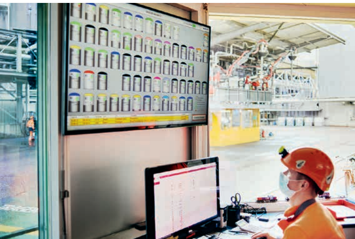
Un pannello riepilogativo mostra, per ogni serbatoio, livello di riempimento e materiale contenuto.
